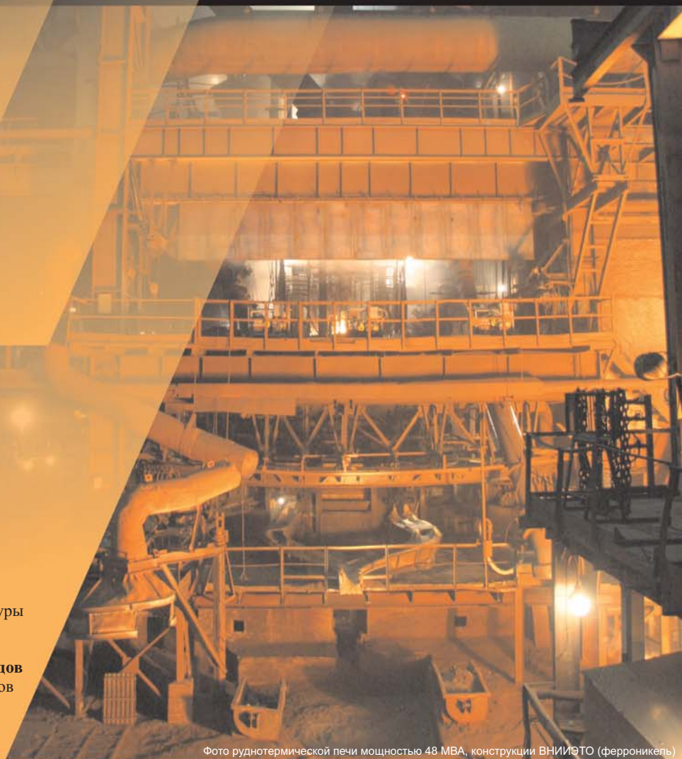
Фото руднотермической печи мощностью 48 МВА, конструкции ВНИИЭТО (ферроникель)
